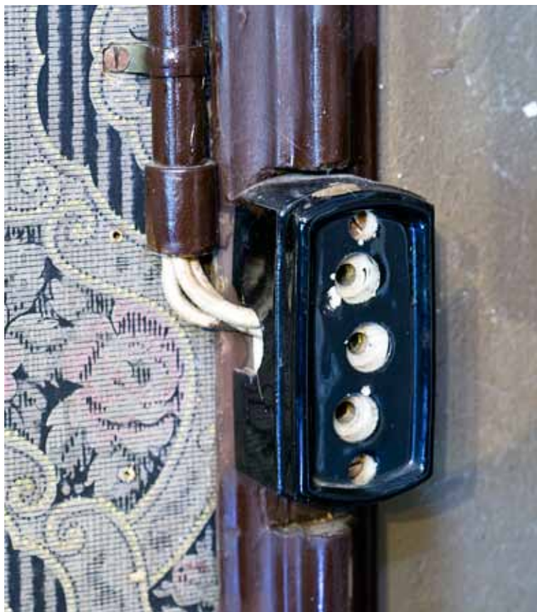
Under: Gammel stikkontakt i porselen montert på brannmurlist.
