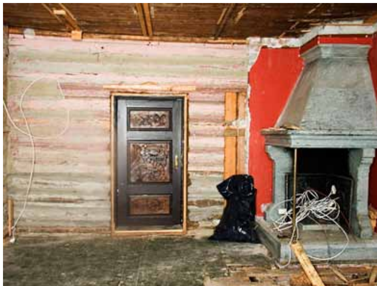
Foto fra arbeidene i Peisestuen 9.06.2006. Bak den delvis nedrevne brannmuren sees en gammel hulltagning i tømmerveggen. Den mangler beitski og er derfor neppe opprinnelige. Snittflatene er relativt friske. Mulig spor etter dør fra tiden før ca. 1840. Panelet på andre siden av veggen tilsier at døren ble fjernet ca. 1840.
